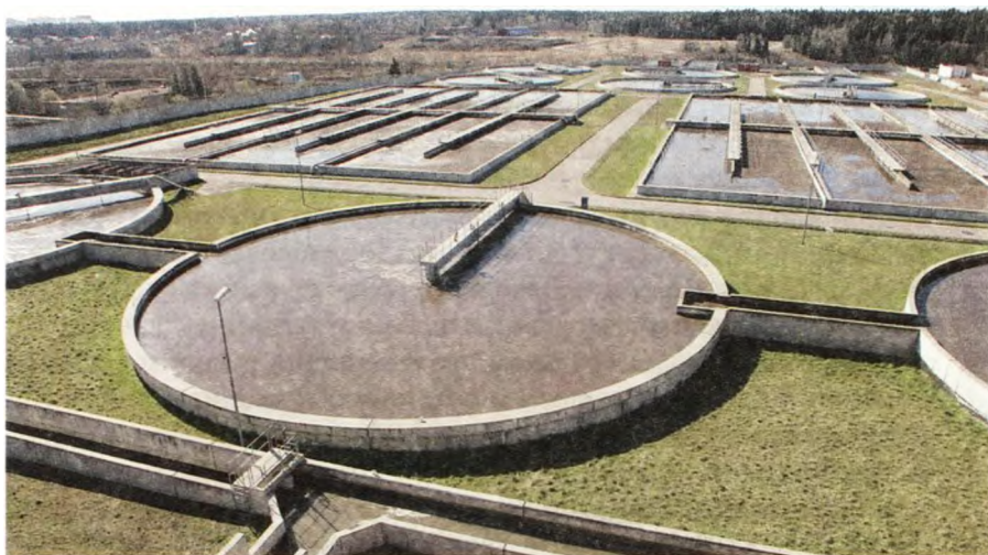
Сооружения биологической очистки: отстойники и аэротенки
