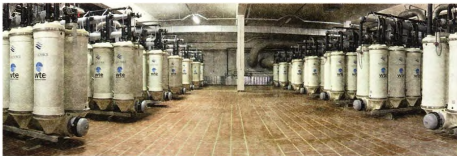
Мембранные фильтры на Юго-Западной водопроводной станции Москвы
